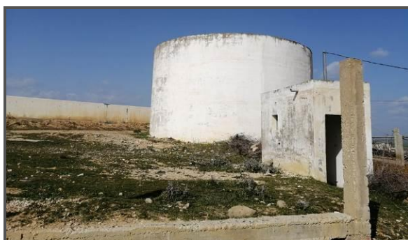
Photo 5 : Réservoir sur sol de capacité 500 m 3 .
